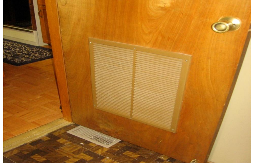
Return air path/ grille in door
